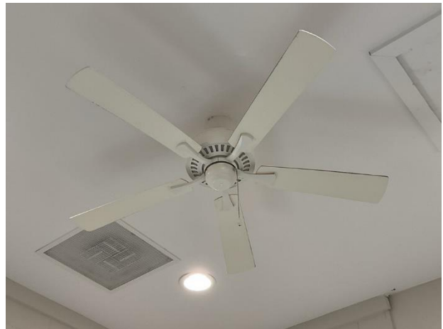
Ceiling fan overview
